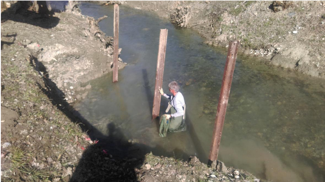
Foto der fertig ausgehobenen Grube und versetzten Eisenbahnschienen (Foto Kästli Bau AG)
