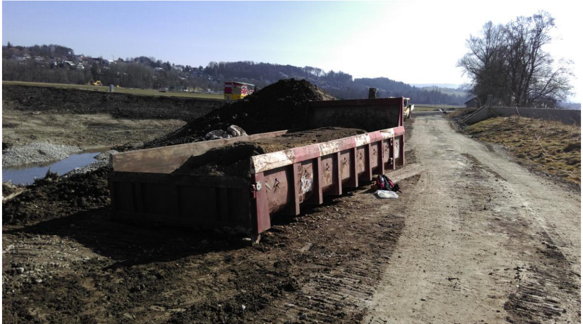
Foto der Abrollmulde auf Baustelle welche das Nistschicht-Material enthält (Foto Kästli Bau AG)
