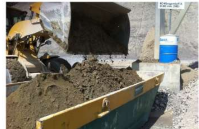
Der Bagger in der Sandgrube füllt das gewählte Substrat in die Mulde.
