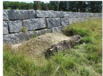
Sandhaufen an Trockenmauer. (Remetschwil)
